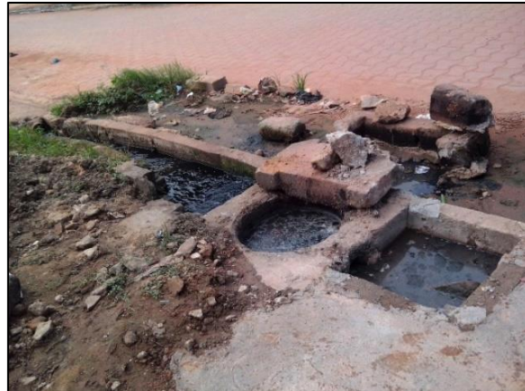
Figure 9 : Réseau d'assainissement saturé au quartier Maytar (Cliché Mayouf, Z., 2021).
