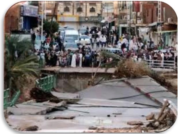
Figure 4. Destruction de deux ponts Source al- Watan, sept. 2024
