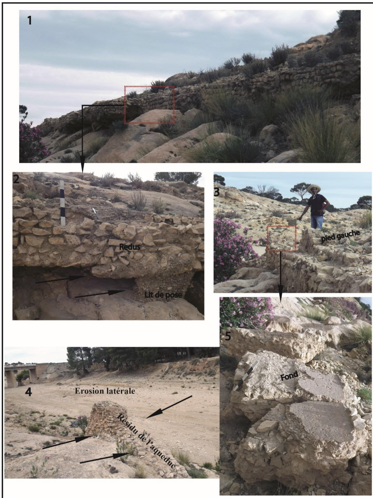
Figure 6. L'aqueduc de Ras El Aïn (1 : vue d'ensemble de l'aqueduc de Fériana, 2 : détail de l'aqueduc de Ras El Aïn, 3 : résidu du pied gauche, 4 : résidu de l'aqueduc affecté par l'érosion, 5 : détail de l'effondrement du fond de l'aqueduc).
