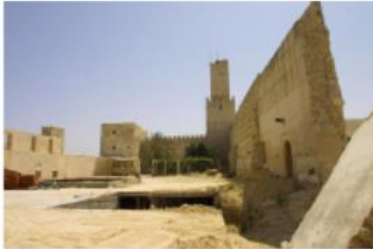
3. سقوط جزء من اسوار القصبة اثناء الاشغال
