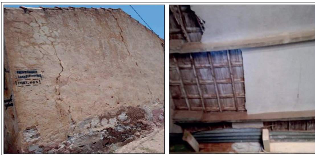
Fig. 2 - Photographies montrant l'effet du séisme (choc principal) sur certaines bâtisses anciennes dans la ville d'Arzew. Il s'agit de fissures dans les murs en maçonnerie ancienne (photographie à gauche) et de chutes des faux plafonds (photographie à droite).
