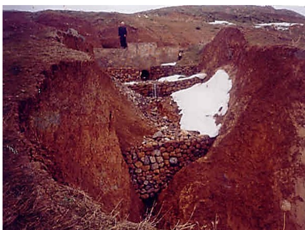
Figure 1. Affaissement des seuils en gabion : Haouch Zegaa (Ouzera).
