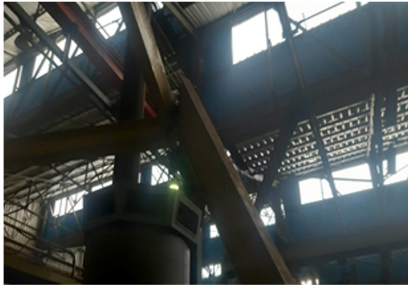
الصورة رقم (06): ضعف الانارة وضبابية في الزجاج الخاص بالأسطح، بالإضافة الى وجود زجاج مكسور يسمح بدخول الهواء البارد شتاء، مع انعدام لنظام التكيف المركزي.
