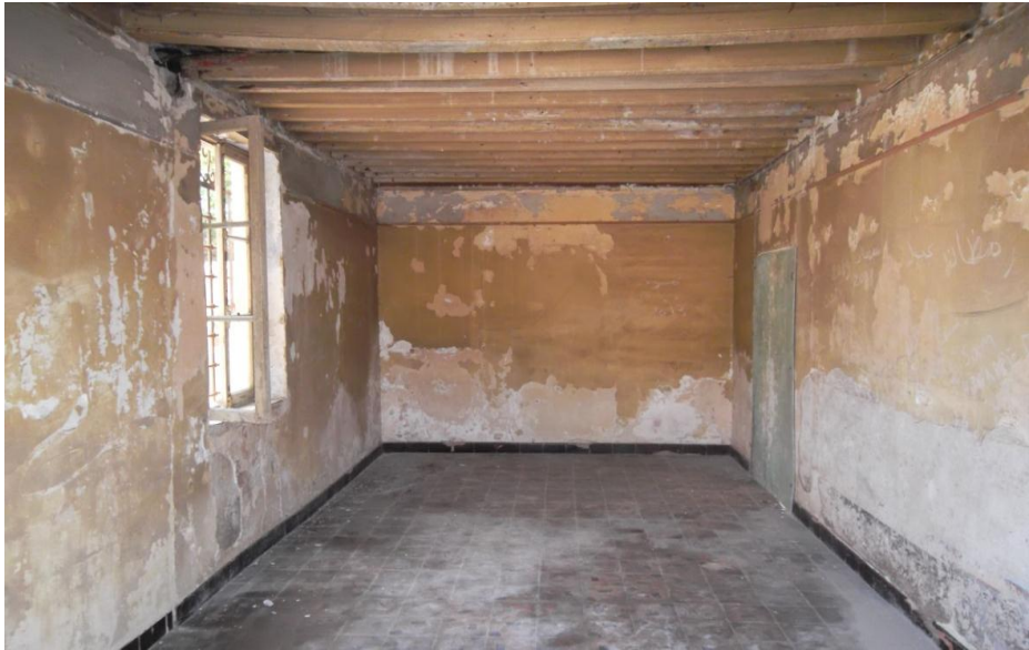
الصورة رقم 06 تشكل طبقات بيضاء بفعل الرطوبة
