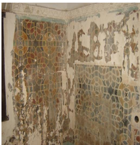
الصورة رقم 09 تعرية في مواد البناء
