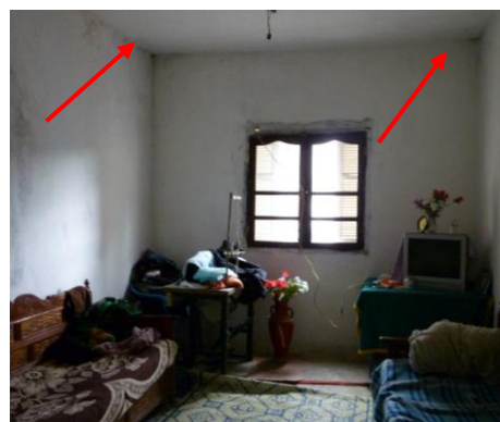
Fig.8. Humidité à l'intérieur des logements
