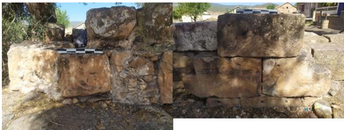
Fig 19 : trous de fixation avec traces de mortier
