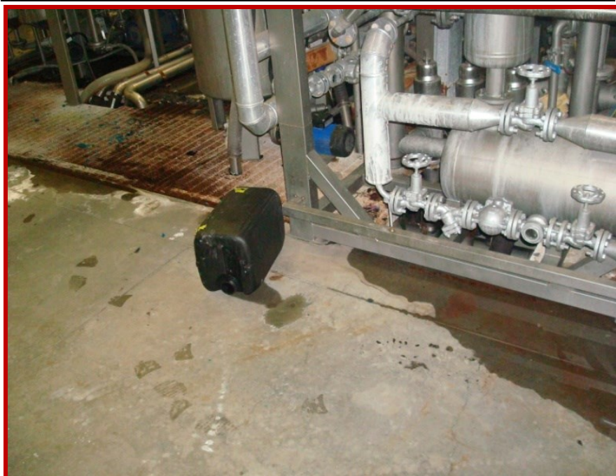
Photo 1 : Stockage hasardeux des produits chimiques dans la zone de travail
