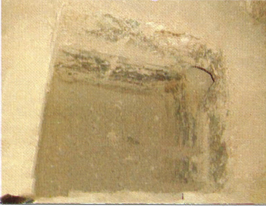
الصورة 3 أ : قناة تصب في صهريج صغير بأرضية المسجد الكبير بمليانة اكتشفت أثناء عملية الترميم الأخيرة .
