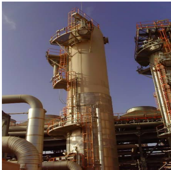
Figure 1. La colonne d'absorption à Garnissage In Salah Gaz (ISG)
