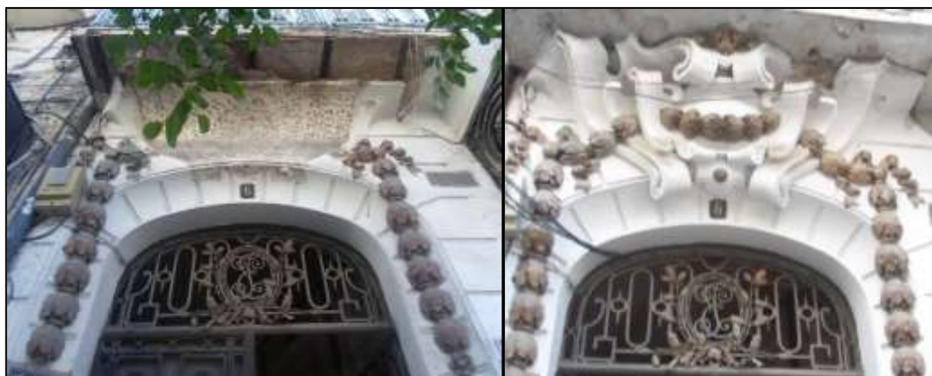
Fig 1. Ornement perdu, esthétique tronquée. Photos du portail de l'immeuble N°06 prises le 25-10-2017 (à gauche) et le 13-10-2012 (à droite). Source : l'auteure
