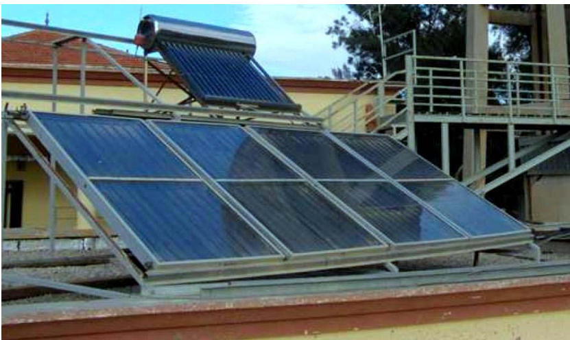
Fig. 5: Vue en premier plan du champ de capteurs plans thermiques de l'installation de production d'eau chaude
