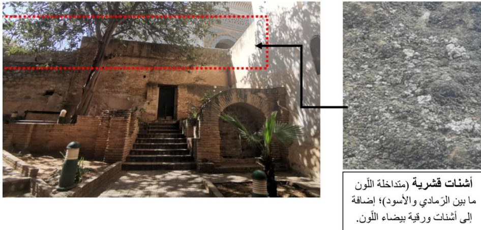
الصّورة (03): آثار أضرار الجدار الجنوبي من سور حديقة القصر.
