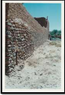
الصورة 12: القنادسة/ واجهة للضلع الجنوبي للسور وتفتية بناد
