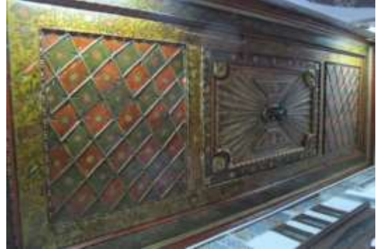
الصورة رقم 11: سقف غرفة بالدار الحمراء بالدار الحمراء
