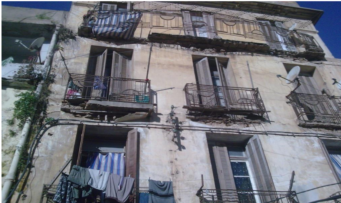
Photo.2 : façades non restaurées dans un état de dégradation avancée
