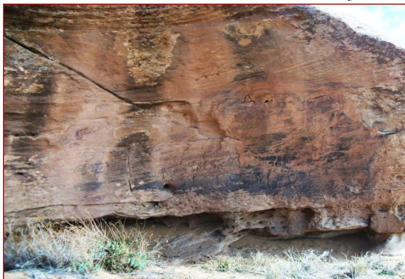
الصورة 2 : تأثير السيول على الواجهة الصخرية لمحطة بوزرطالة
