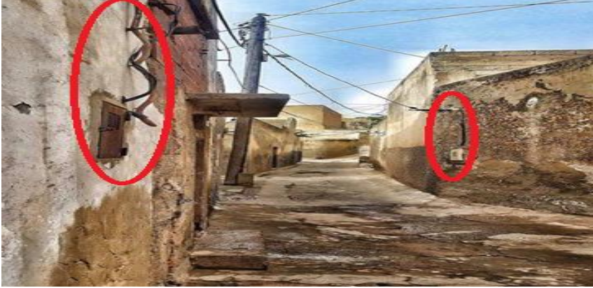
صورة رقم (09): ربط المساكن بشبكة الكهرباء والغاز على الجدران مباشرة وما تحدثه من انهيارات
