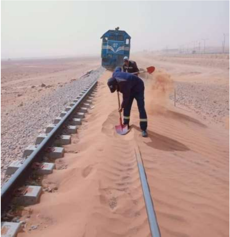
Photo 3. Envasement de la voie ferrée, interrompant les trajets sur cette ligne pendant plusieurs mois, engendrant des pertes économiques et des désagréments pour la population locale.
