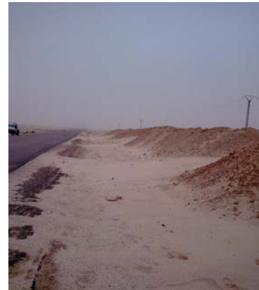
Photo. 4 l'abord immédiat de la route est complètement désensablé
